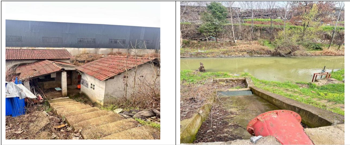
图 3 陆水社区排涝泵站
